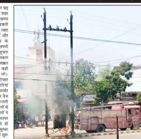
को मशकत कर ठक आग पर नियंत्रण पाया। जनाहानि नहीं हुई, लेकिन ट्रंसफार्मर पूरी तरह क्षतिग्रस्त हो गया। राहत की बात यह रही कि घटना में कोई भी जानकार नहीं मारा।
