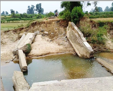
नाले पर बने क्षतिग्रस्त पुलिया का जल्द नवीन निर्माण करवाने की मांग शासन-प्रशासन से की है ताकि आने-जाने में हो रही परेशानियों से निजात मिल सके।
